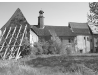
Ein Blick von der Gartenseite offenbart die gefährdete Bausubstanz.
